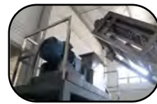
破碎系统 Crushing
